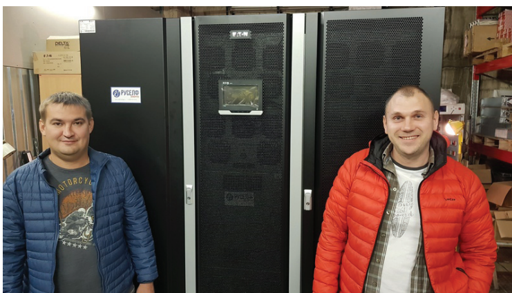
Рис. 1. На космодроме «Восточный»: специалисты «РУСЕЛФ Энерго» доставили ИБП Eaton 93РМ на объект
